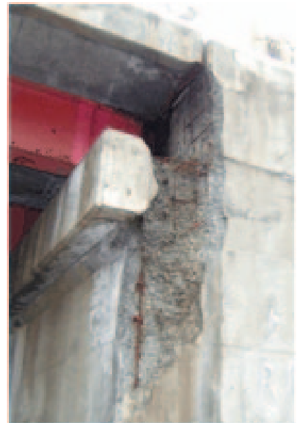
写真2 橋台の損傷例
