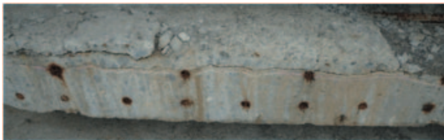
写真3 床版の損傷例
