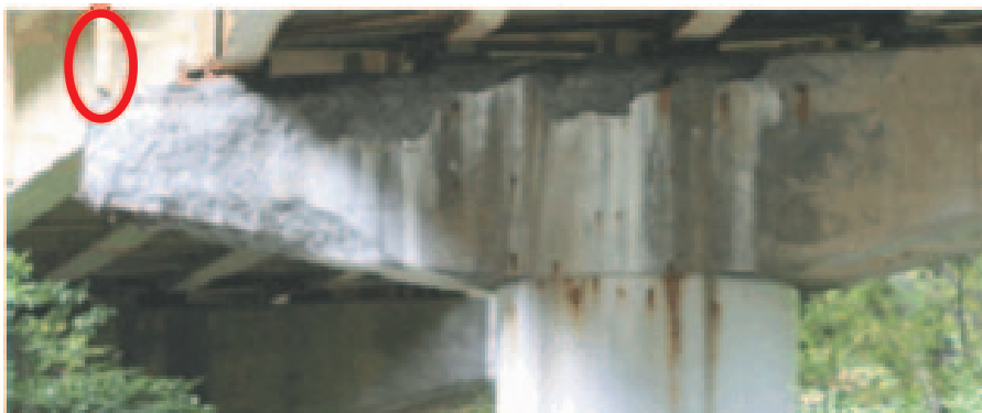
写真1 橋脚の損傷例
